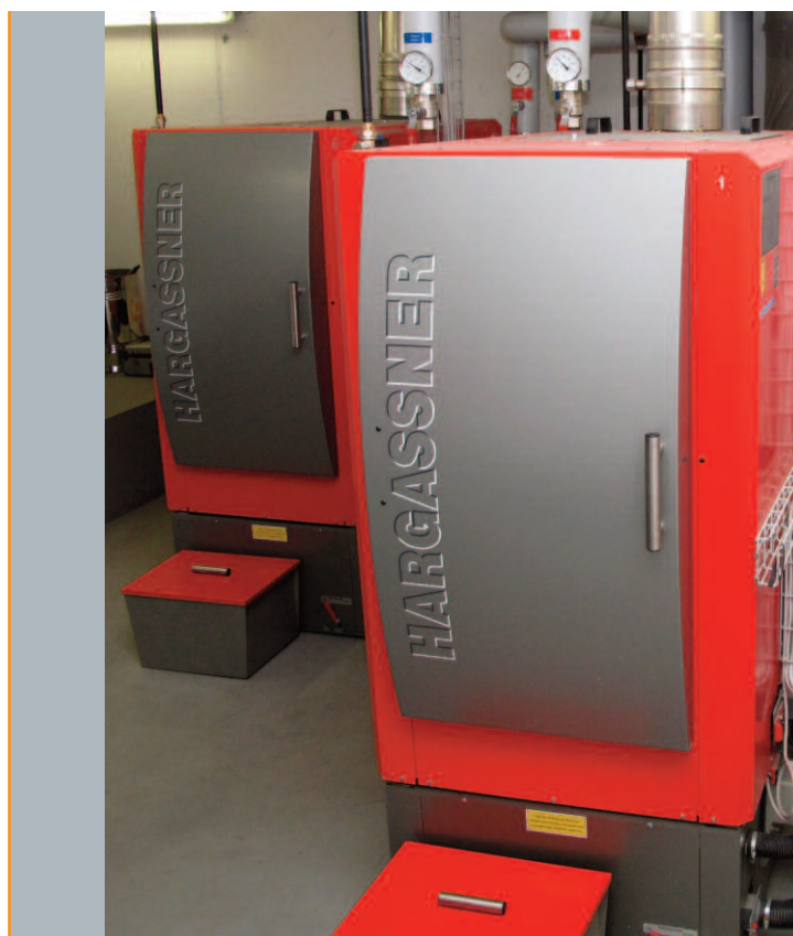
Le due caldaie a cippato da 100 kW l'una
