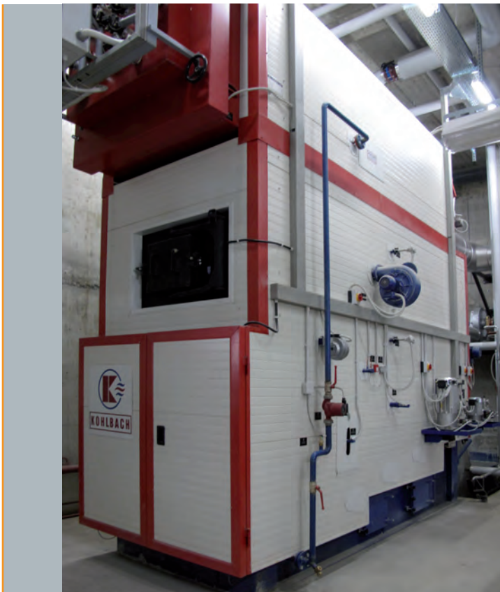
La caldaia a legna di 1200 kW, è il cuore dell'impianto.
