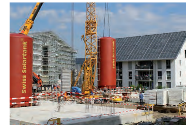
Ces accumulateurs solaires couvrent les besoins en eau chaude et chauffage de huit grands appartements pendant toute l'année.
