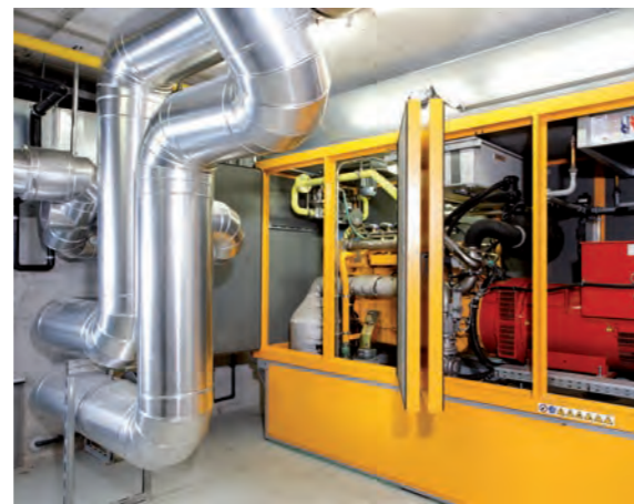
En 2012, les 18 réseaux de chauffage d'ADEV ont fourni près de 11,5 millions de kWh de chaleur et 2,5 millions de kWh d'électricité pour des centres commerciaux, des écoles, des entreprises industrielles et artisanales, des hôtels et 450 logements.
