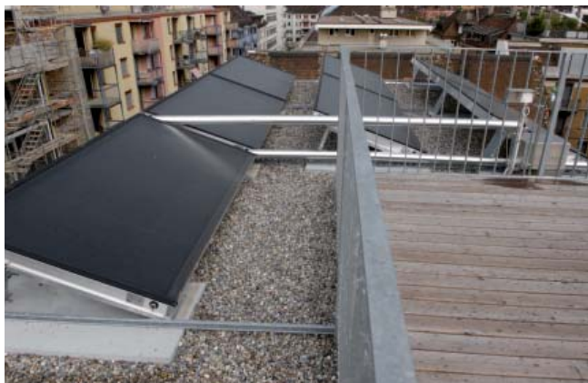
Collettori solari sul tetto dell'edificio di Wogeno, Zurigo
