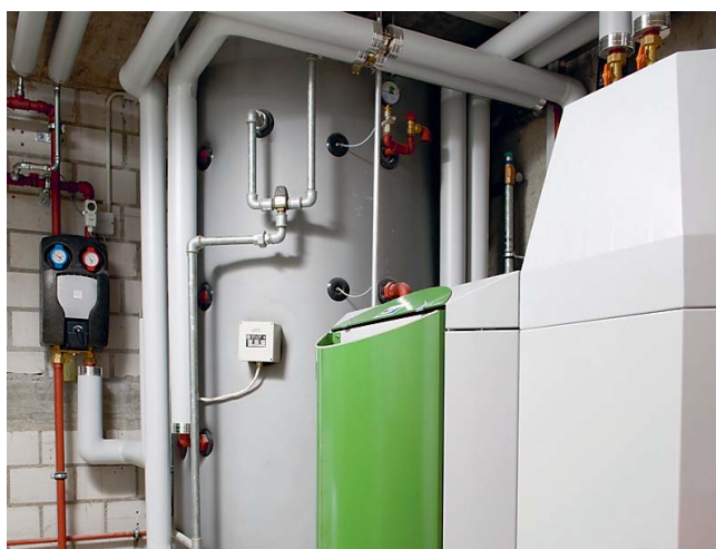
La caldaia a pellet di casa Reist
